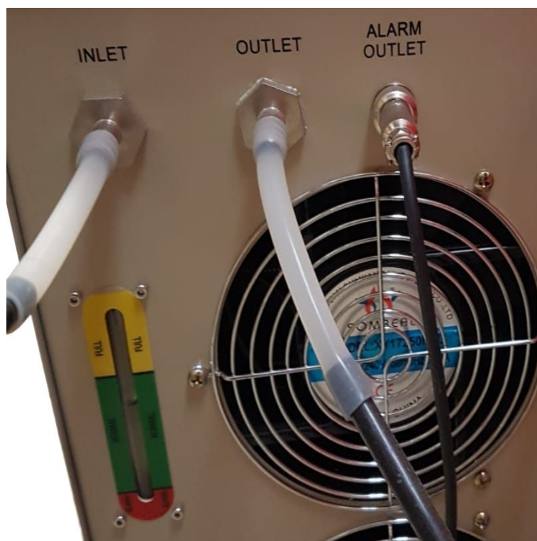
Ilustración 12: Nivel de agua del enfriador
