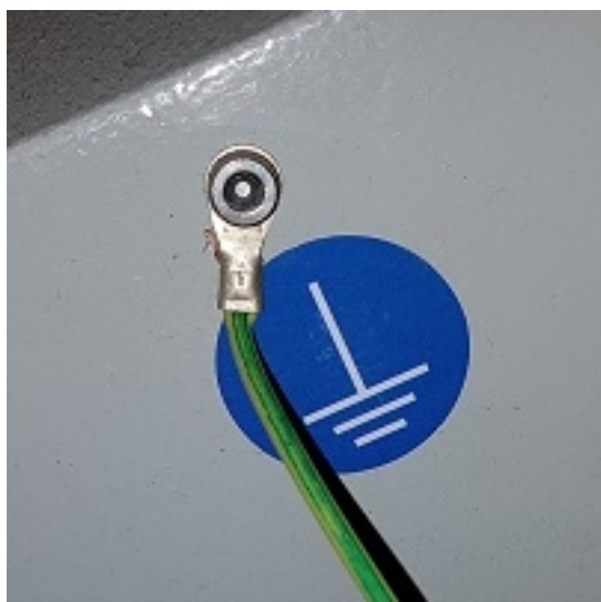
Ilustración 5: Toma de tierra de la máquina
